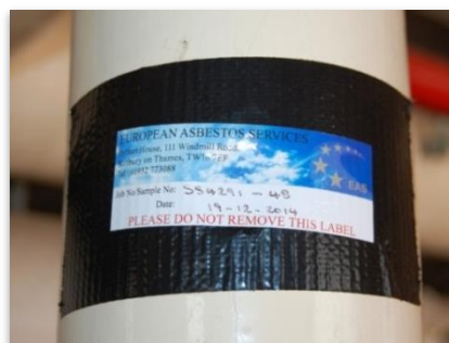
Tubo contrassegnato per la presenza di amianto, Fonte: UEPG
